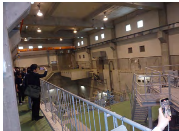
水力発電、放流設備の説明
