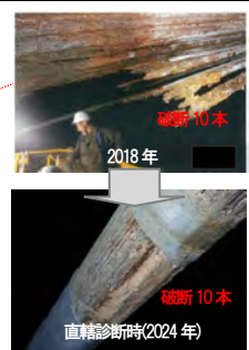
写真-2(2) 主な素線破断状況 (左側斜材部)
