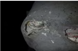
写真-3 被覆材の損傷
