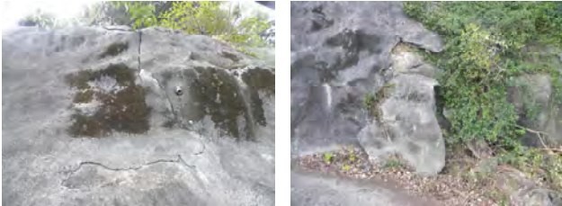
写真-12 地山被覆モルタルのひび割れ・剥離
