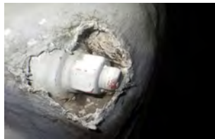
写真-4 被覆材の損傷
