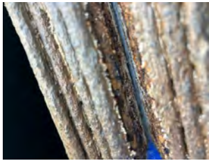
写真-15 素線腐食
