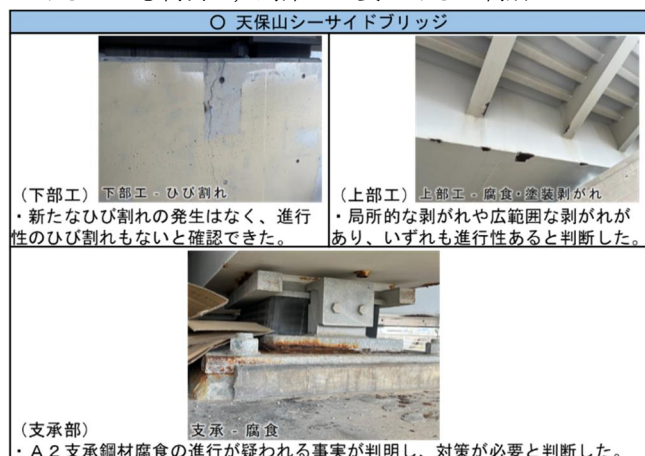
（図2-5）現地踏査の結果・変状の写真
