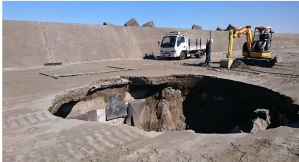
図-4 空洞化による陥没事例
