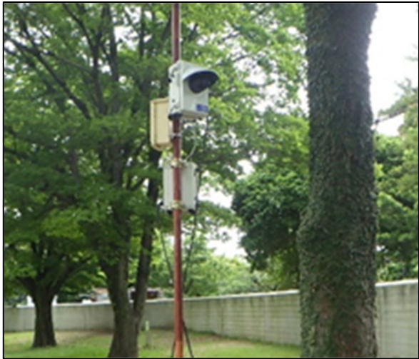
写真 3-3 追加した防犯カメラ
