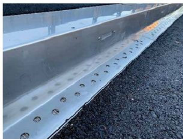
写真-6鋼製排水溝
