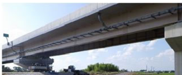
写真-5排水桝+横引管
