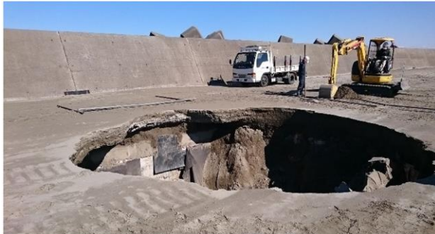
図-4 空洞化による陥没事例
