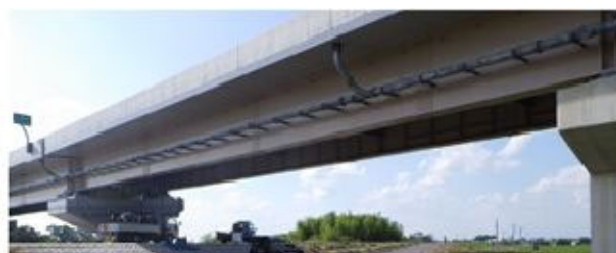
写真-5排水桝+横引管
