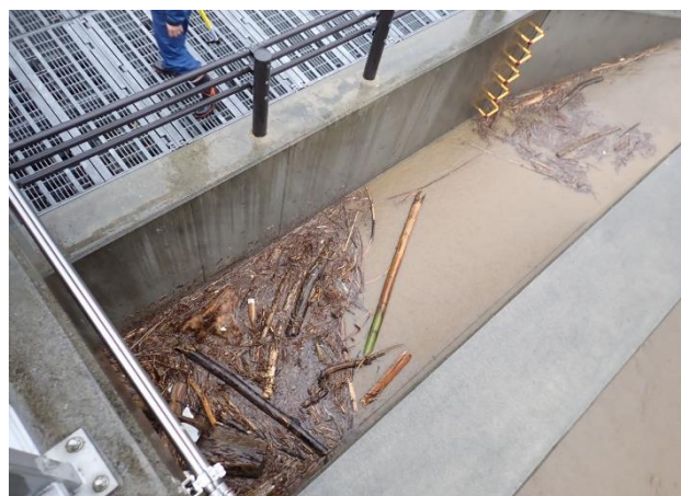
写真-2 取水口付近に堆積した塵芥等
