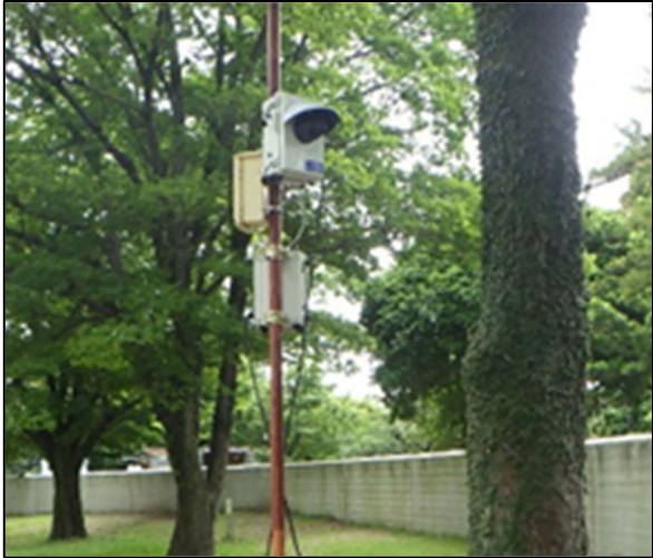
写真 3-3 追加した防犯カメラ
