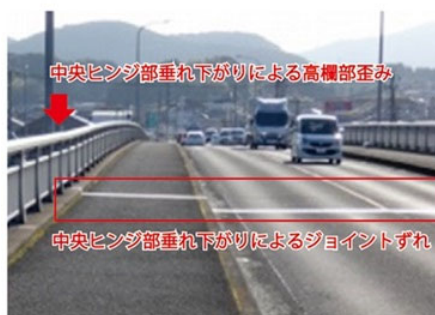
図-6 中央ヒンジ部の垂れ下がり
