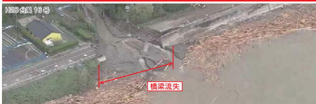
台風 16 号により磯橋流失 (H28.9.21 国道 220 号)
