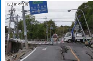
地震により道路が被災 (H28.4.16 国道 443 号 [県管理])
