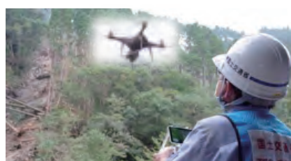
ドローンによる被災状況調査
