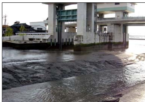
河川管理施設周辺のガタ土堆積 (花宗水門:大川市)
