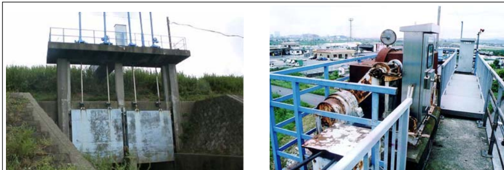
老朽化した河川管理施設
