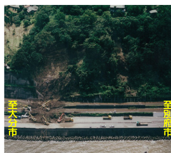
▲ 法面崩壊による通行規制時の状況 (H5.9、白木地区)
