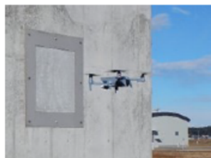
ドローンによる損傷把握
