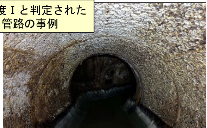
管の腐食から緊急度Ⅰと判定
