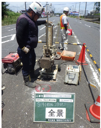
貫入試験による空洞調査
