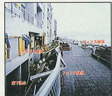
被災状況(H5.9)
