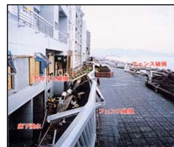
被災状況(H5.9)
