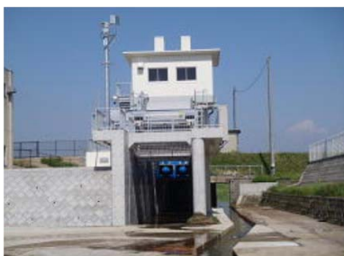
ゲートポンプを増設した若菜排水樋門
