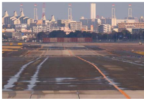
航空機の車輪による「わだちぼれ」の発生
