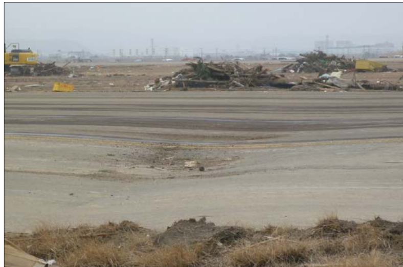
地震発生後の液状化現象による基本施設(誘導路)の沈下状況(仙台空港)
