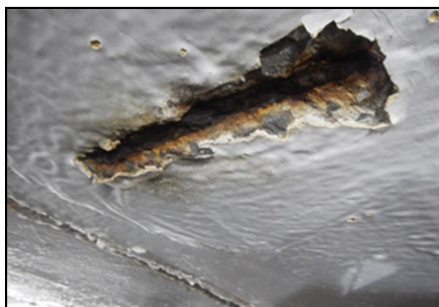
コンクリートの剥離
