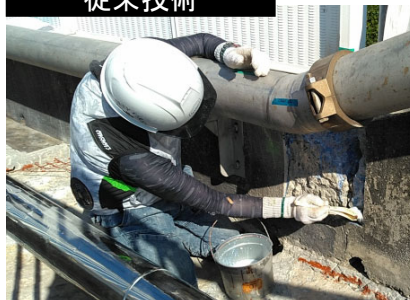
腐食による再劣化の懸念
