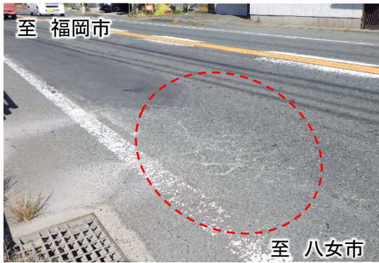
路面クラック(近景)
