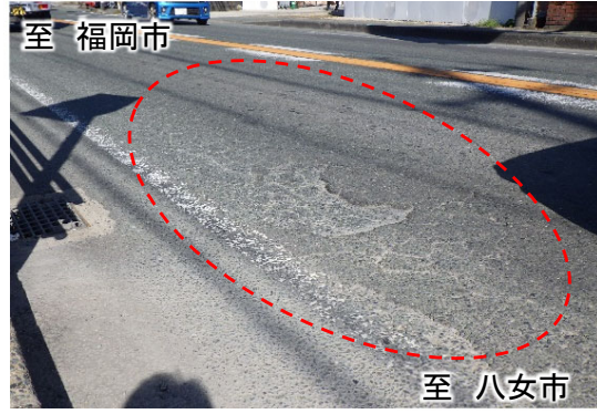
路面クラック(近景)
