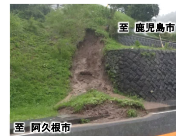
写真①：法面崩壊状況
