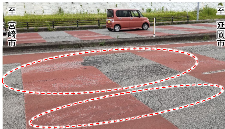
路面クラック・わだち掘れ(近景)
