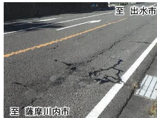
路面クラック(近景)
