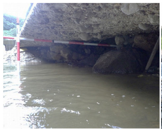
洗掘状況(近景)
