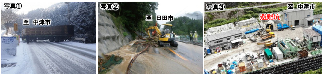
▲ 積雪凍結事故発生状況 ▲ 風水害による土砂流出状況 ▲ 1号トンネル避難坑工事状況
