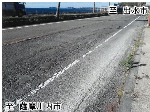
路面クラック(近景)
