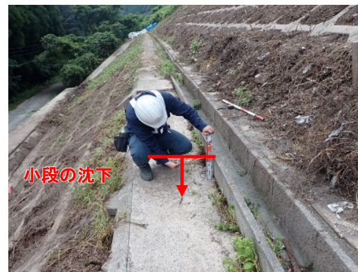
小段沈下(近景)
