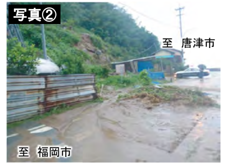
写真② 至 唐津市 ▲H22.7.13 法面崩壊 (糸島市二丈浜窪地区)
