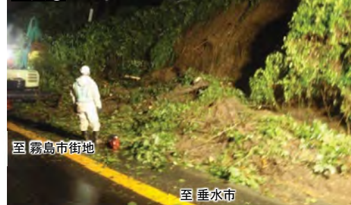
▲ 斜面の崩壊 (H27.6)
