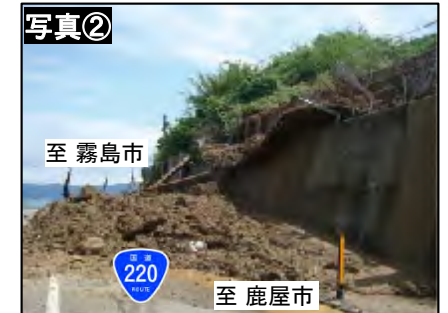
▲ H24.6 斜面の崩壊
