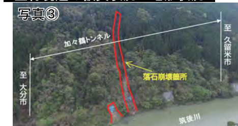
▲H28熊本地震による被災状況
