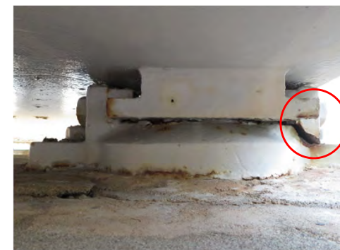
【支承の損傷】【写真③】 （支承のサイドブロック破断）
