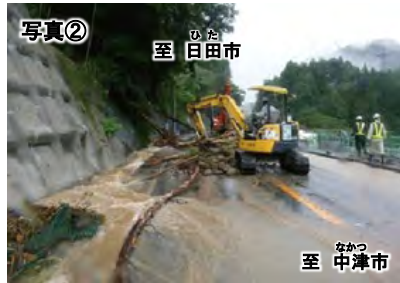
▲ 風水害による土砂流出状況
