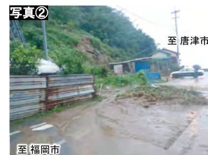
写真② 至 唐津市 ▲H22.7.13 法面崩壊 （糸島市二丈浜津地区）
