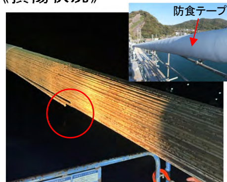
【主ケーブルの破断】【写真②】 （防食テープを外し調査実施）
