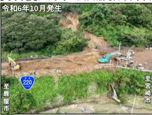
【写真②】大雨時の法面崩壊(串間市)
