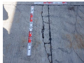
エプロンのひび割れ状況
