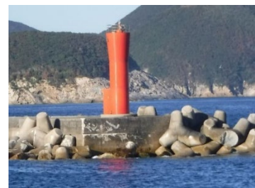
防波堤(北) 越波状況
