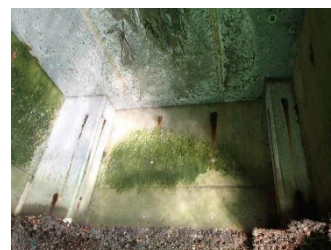
上部工の損傷状況
