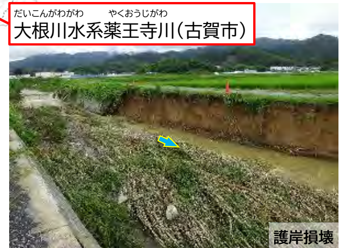
堤防溢水状況
