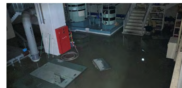
反応槽(地下1F)の浸水状況
