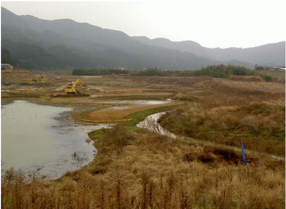
クレーク右岸天端高の切り下げ工事の状況（平成 18 年 2 月 7 日）
