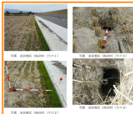
堤内地の水田で生じた漏水の確認状況
