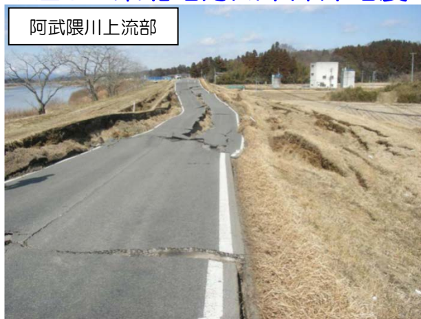
地震による堤防の被災状況
