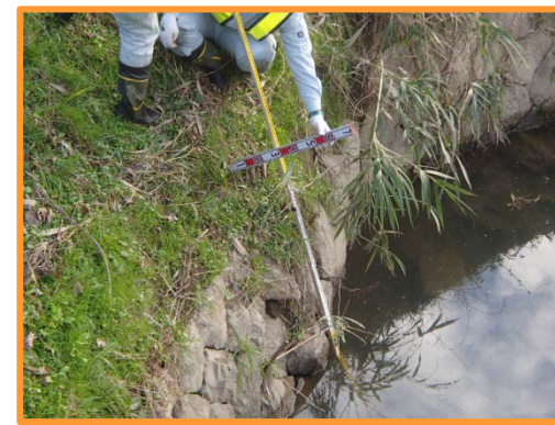
老朽化した低水護岸
