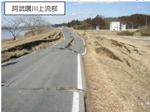
地震による堤防の被災状況
