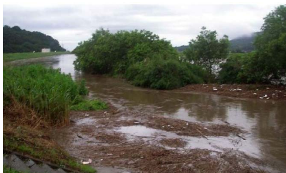
●河道内樹木による流下阻害
