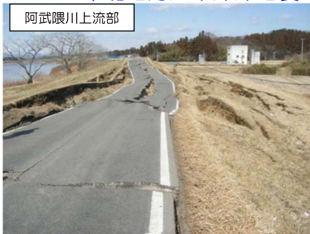
地震による堤防の被災状況
