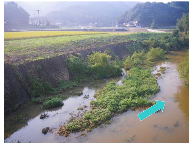
管理用通路が整備されていない
