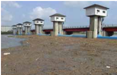
写真 2.3.67 松浦大堰に溜まった ゴミの様子
