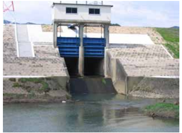
写真 2.3.51 横断的連続性を分断した樋門
