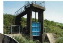
●老朽化構造物の様子
