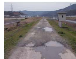
●堤防天端不陸の補修前
