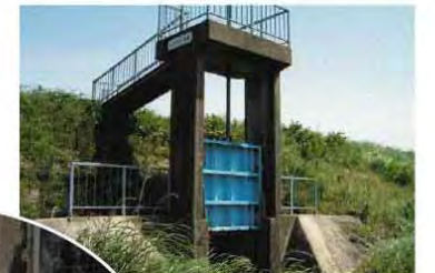
●老朽化樋管の様子
