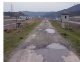
●堤防天端不陸の補修前
