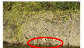
●護岸変形の様子
