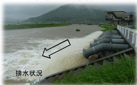
東川排水機場の運転
