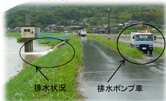
排水ポンプ車 運転(鐘撞川排水樋管)
