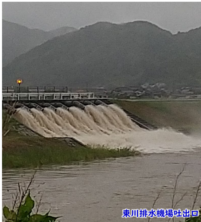
24時間体制で稼働中の 高橋排水機場
