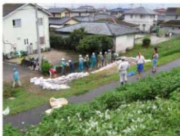
被災箇所①
