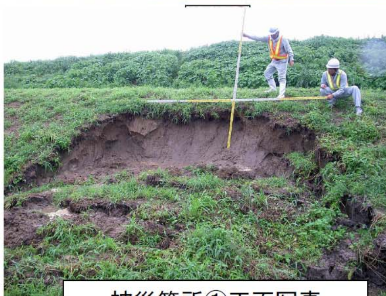
被災箇所①正面写真
