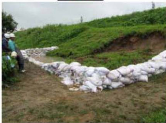
被災箇所①
