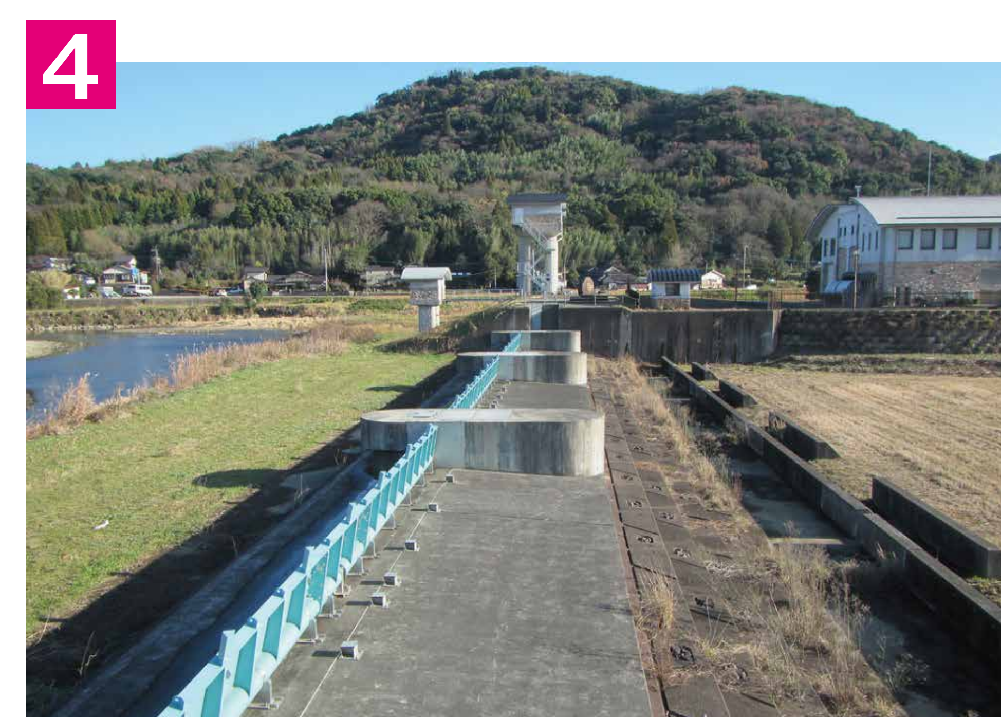
4 越流堤 えつりゅうてい 【延長70m】 牛津川の水位が高くなったら、ここから遊水地内に水が入ります。
