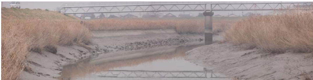
写真 河道に堆積するガタ土
