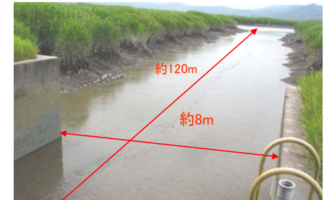
樋管前面水路のガタ土堆積状況
