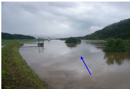
写真 2.1.8 河道内樹木による流下阻害状況
