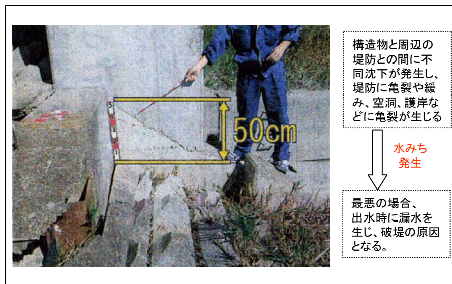
図 2.1.8 排水樋管周辺の地盤沈下
