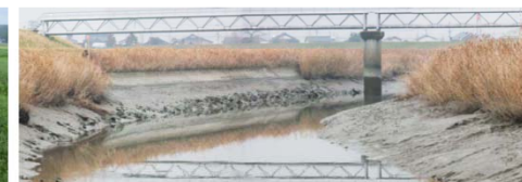
写真 2.1.2 河道に堆積するガタ土
