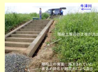
図 階段工周辺の 侵食状況
