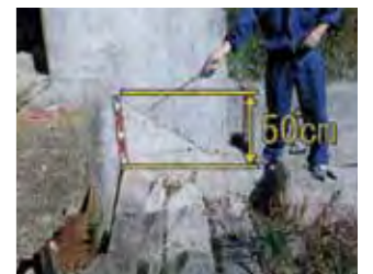
● 排水樋管周辺の地盤沈下
