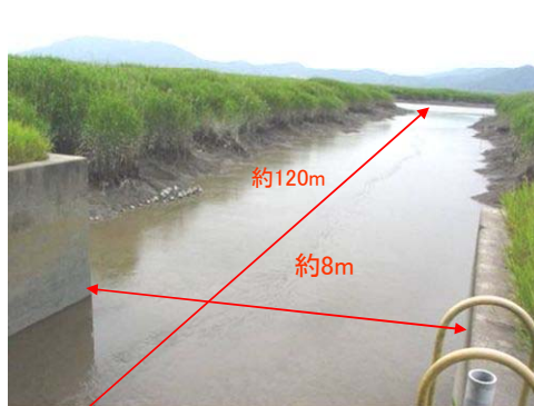
写真 2.1.10 樋管前面水路のガタ土堆積状況
