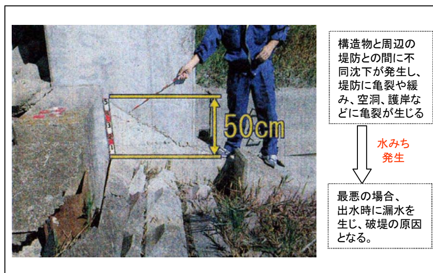
図 2.1.8 排水樋管周辺の地盤沈下
