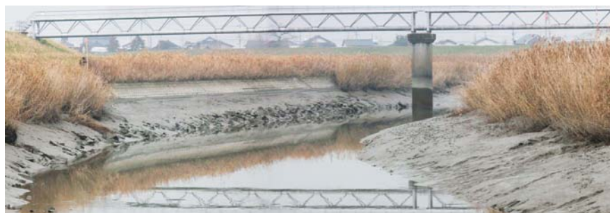
写真 2.1.2 河道に堆積するガタ土
