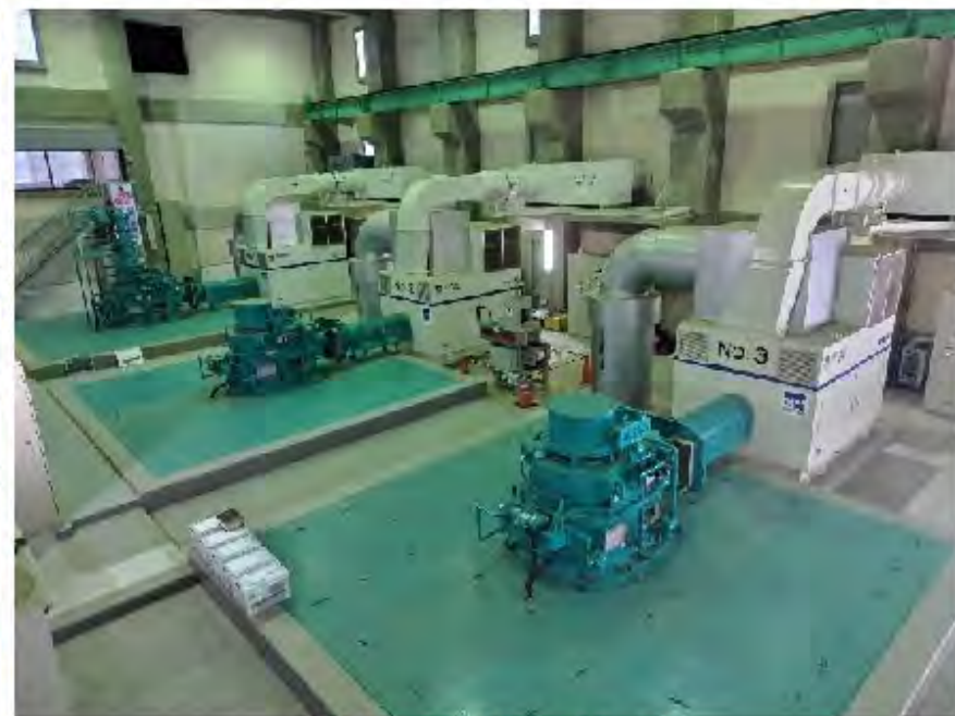
増強した3台のポンプ
