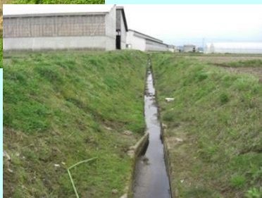
水路側壁の倒壊
