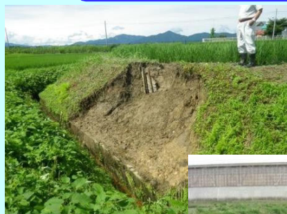
水路法面の崩壊
