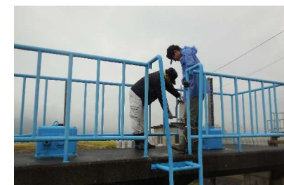
ゲート操作による排水調整
