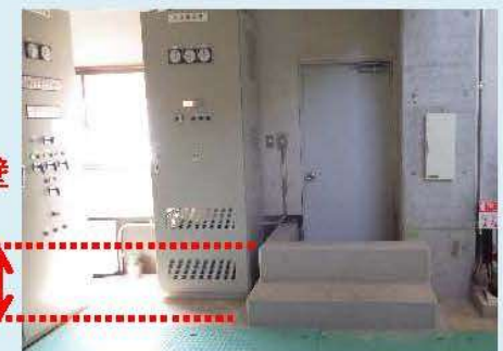
納所排水機場（多久市）
