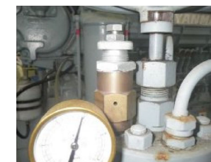
(排水機場)原動機の固着
