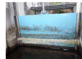
(用排水路)水門設備の扉体劣化
