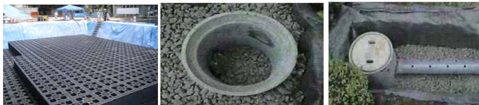
＜雨水貯留浸透施設（左から貯留施設、浸透ます、浸透トレンチ）＞
