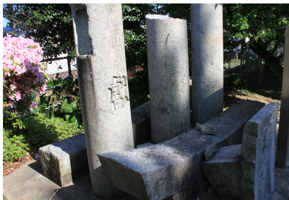
本震で倒壊した鳥居（鳥栖市原町 菅原神社）
