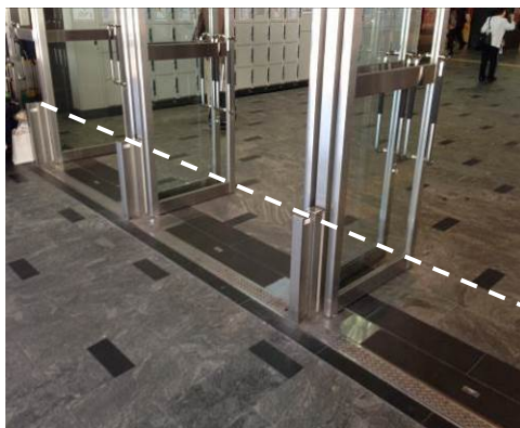
写真1 JR 博多駅入口付近の 浸水防止板設置枠(1/2)
