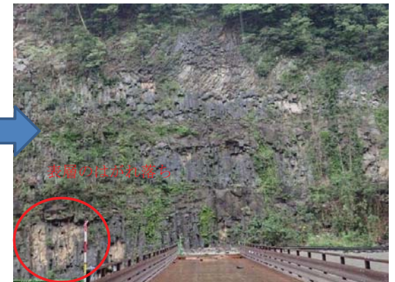
写真-4.3.3 ダムサイト右岸（地震後）
