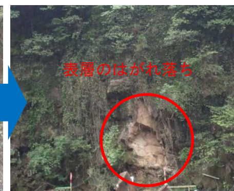
ダム敷右岸（地震後）
