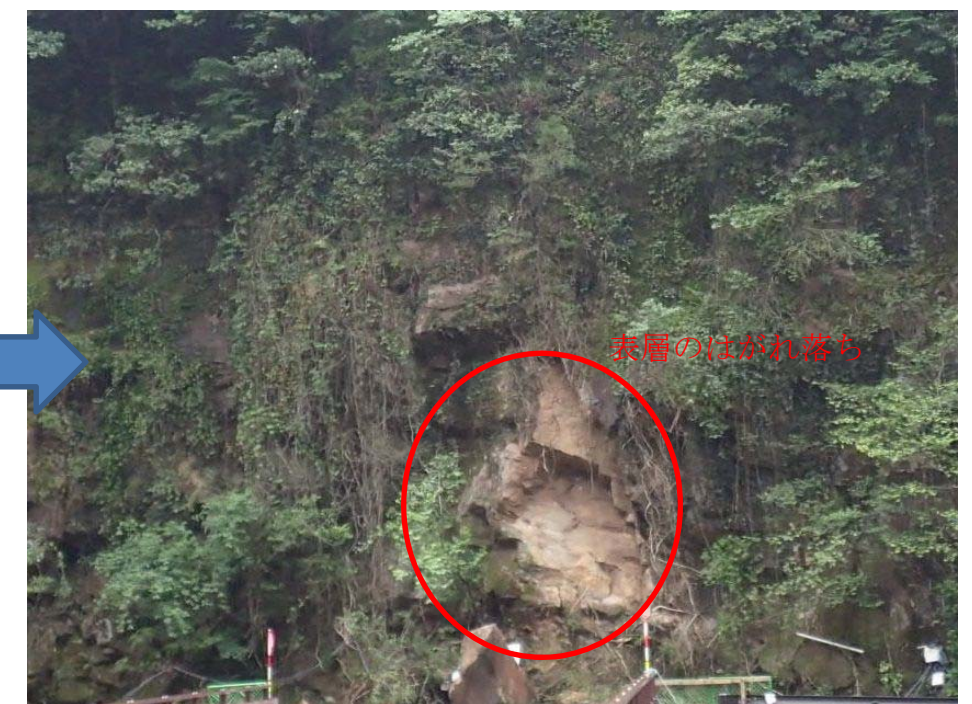
写真-4.3.5 ダムサイト左岸（地震後）
