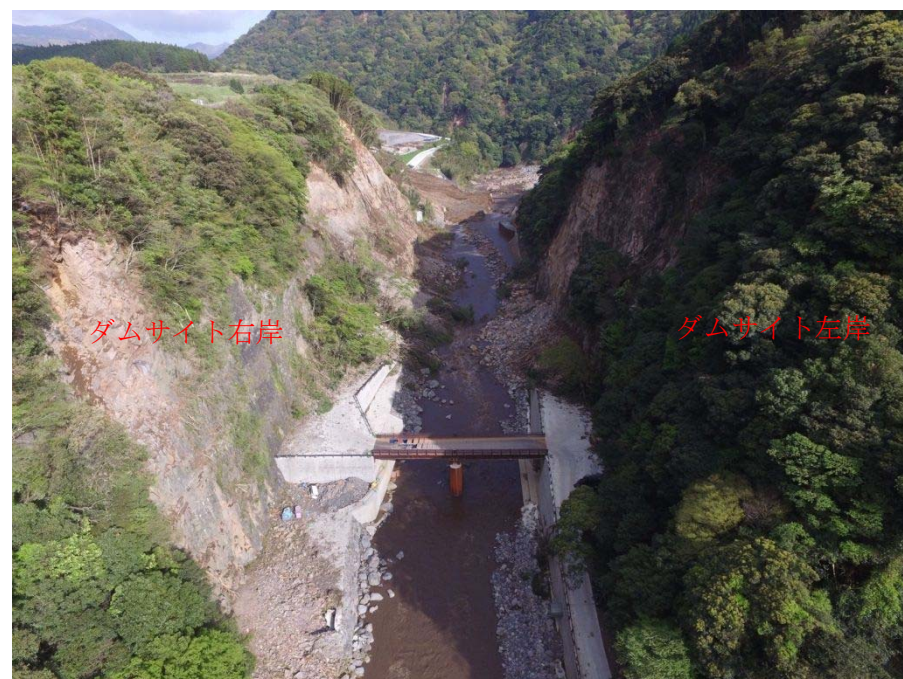
写真-4.3.1 ダムサイト状況（地震後）
