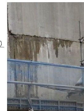
充水試験時の上流面漏水事例
