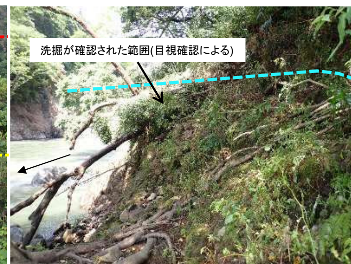
中流-②コドラート内(洗掘部分) 令和 5年7月6日撮影
