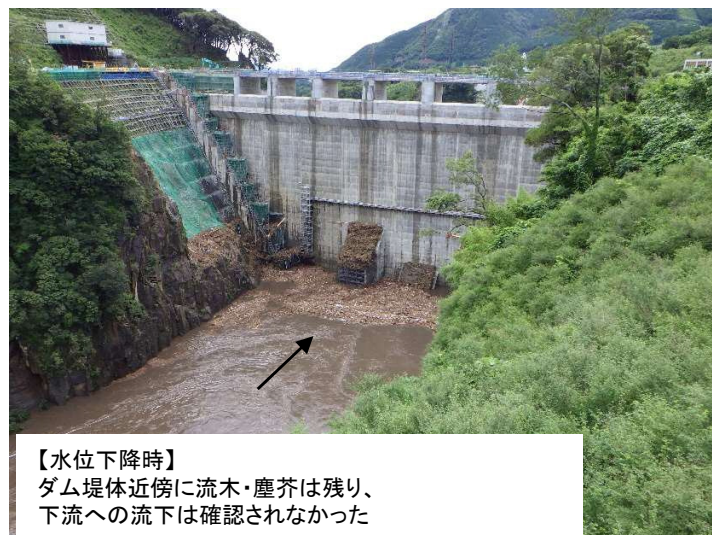
湛水状況 (R5.7.3 15:10頃)
