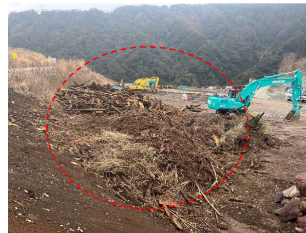
流木塵芥仮置状況
